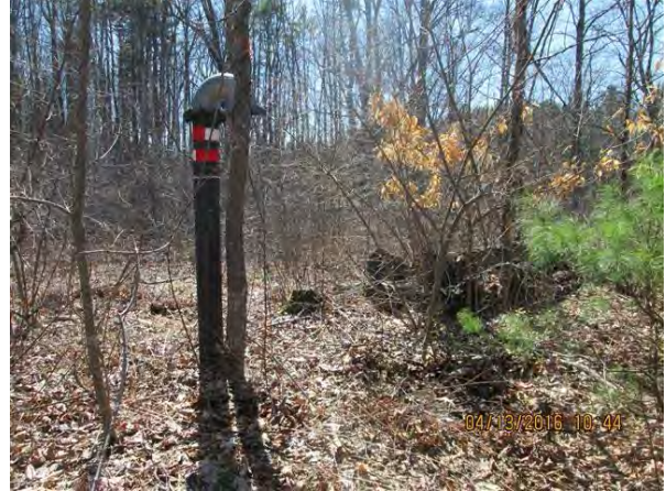
Figure 2-32: AV #8 chamber and vent pipe
